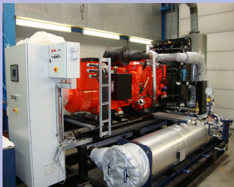
360 Kva Diesel en 230 Kg/stoom
